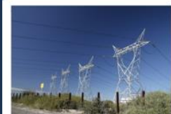
Đường Dây 500kV Bắc - Nam (1.487 km)
